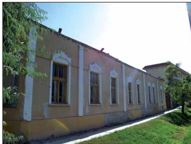
Klucsár u. 2. lakós és melléképületek bontása, ideiglenes kerítés építése a Klucsár és az Alkotmány utca felől. A belső betonkerítés elbontása (összenyitás a gimnázium udvarával), tereprendezés. Bekerülés 1.087.500 Ft
